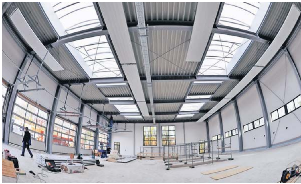
In der künftigen Werkstatt-Halle wird fleißig gearbeitet. Sie soll im 1. Quartal 2014 fertig sein.
